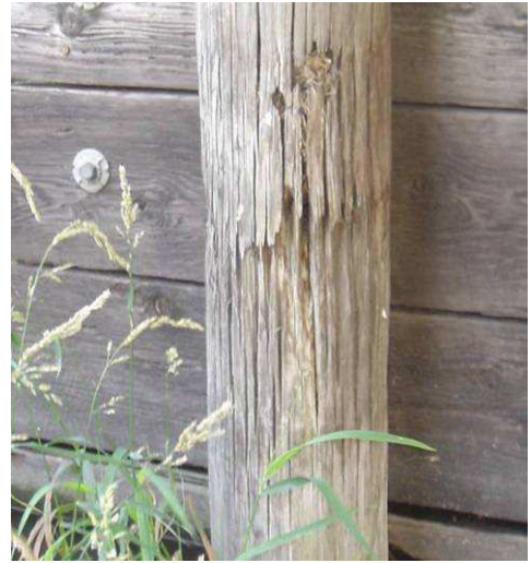
(b) Rotten pile
